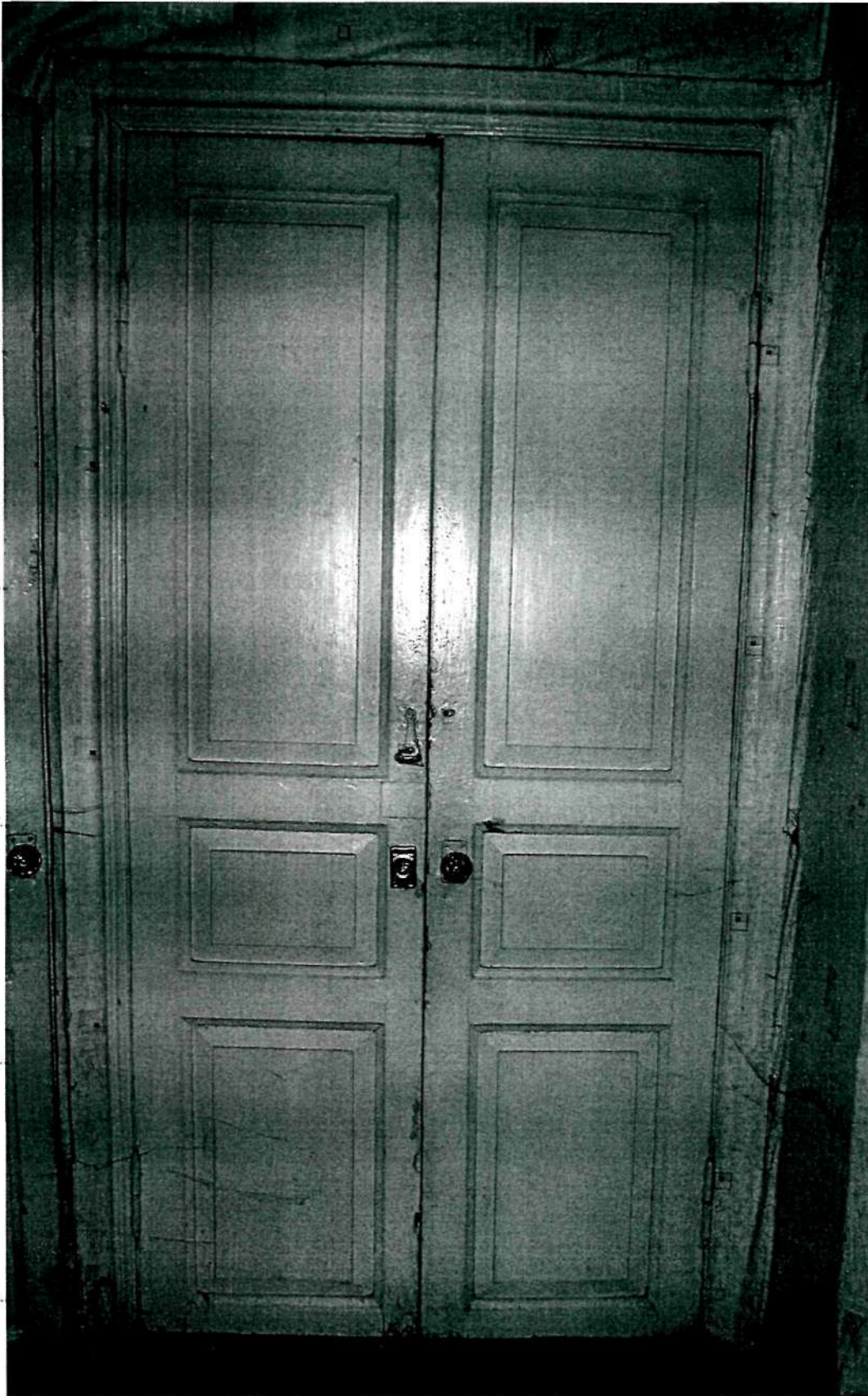
Фото 11. Интерьер первого этажа; филенчатая дверь, распложенная в проеме южной стены комнаты, соответствующей средней оконной оси северного фасада основного объема объекта (в уровне первого этажа); аналогичные дверные
